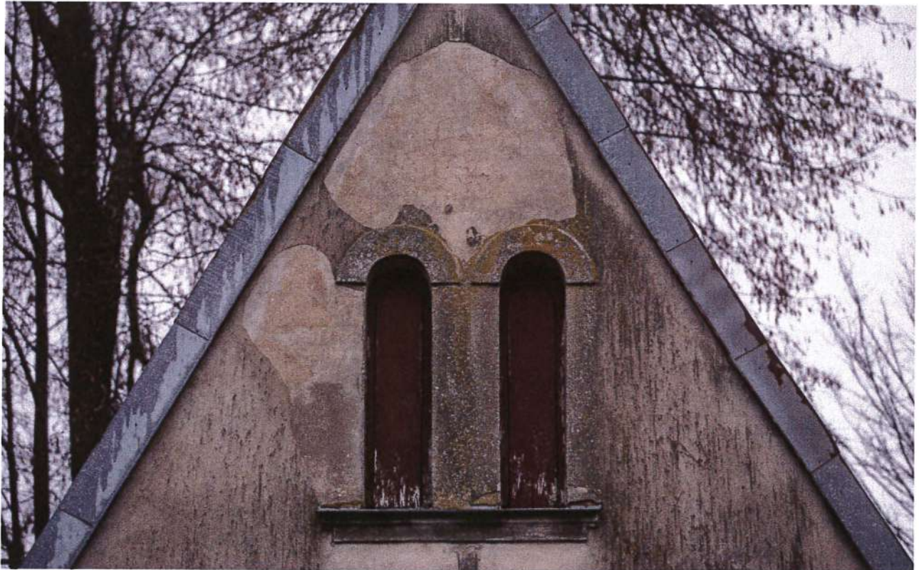
Zambrow kaplica rodziny Woyczyńskich z 1870 r., elewacja zachodnia, stan tynków - widoczne historyczne tynki pod warstwą cementowej skorupy.
